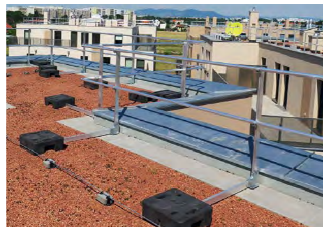
Sicherheitsgeländer selbsttragend Standard als Dachrandsicherung
